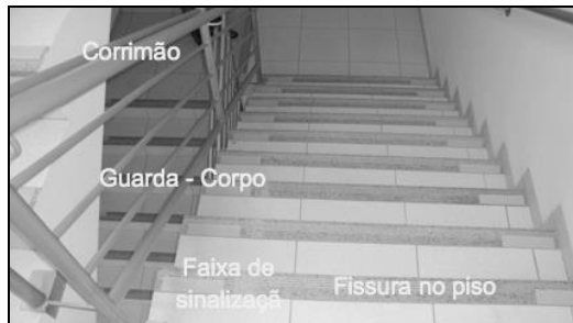
Figura 12: Elementos de segurança da escada do Prédio da Central de Laboratórios do Departamento de Cartografia (Denis Gastaldi, 2012)
