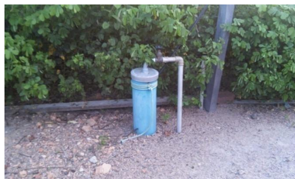
Figura 4. Poço tipo tubular
