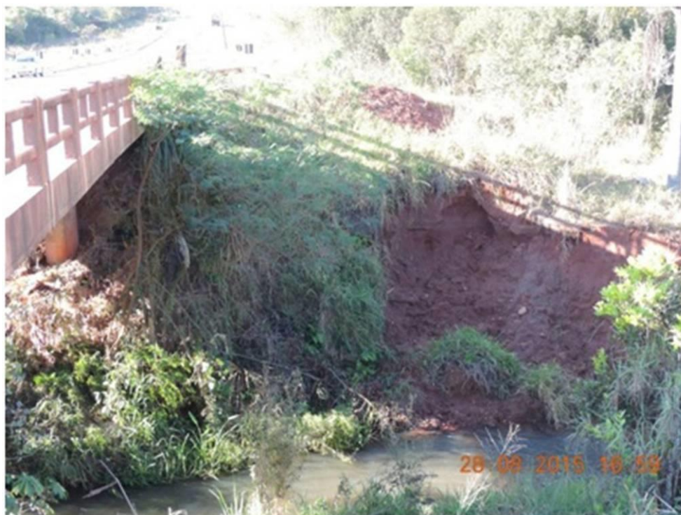
Figura 10 - Falta de Manutenção da Rodovia MS-395 acabou intensificando a Erosão na margem esquerda do Córrego Moeda. Fonte: Próprio autor.
