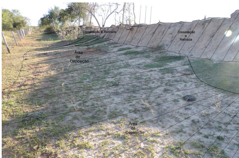
Figura 11 - Área de Dissecação e Retirada de Sedimentos, com erosividade Suavemente Média. Fonte: Próprio autor.
