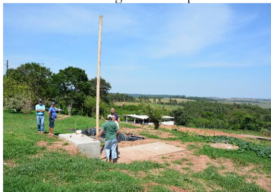
Figura 8a. Tubulação para alívio dos gases formados no interior do tanque séptico.
