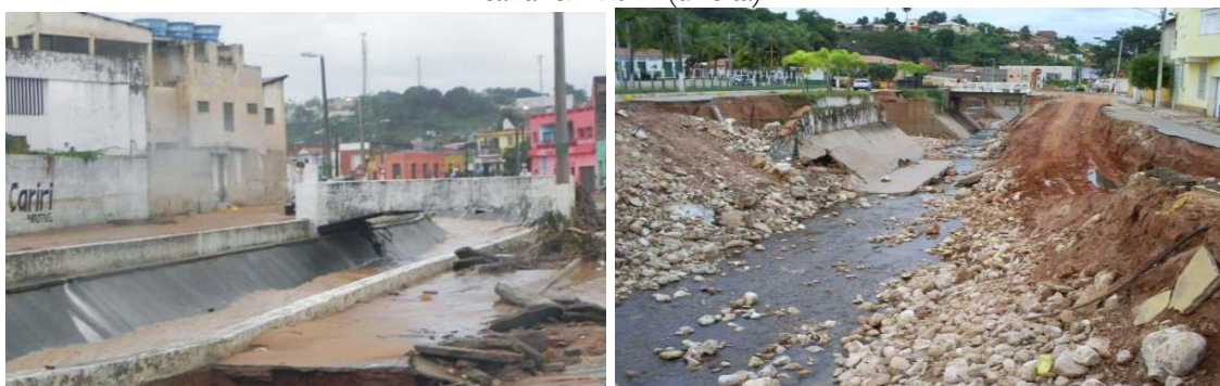
Figura 4. Ocupações às margens do Rio Granjeiro (esquerda) e danos causados pela inundação do canal em 2011 (direita)
