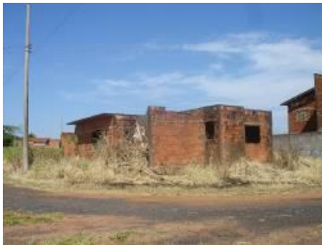
Figura 17. Obra abandonada no interior do Auferville III.
