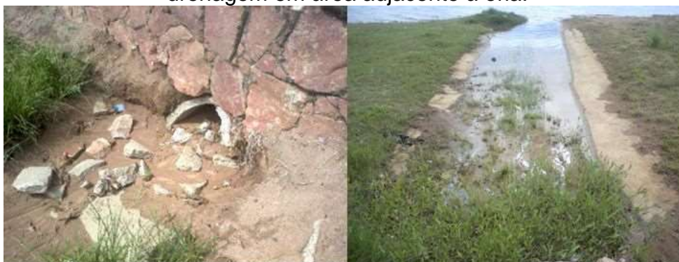
Figura 5 – Processo erosivo de galeria de água e assoreamento de canal de drenagem em área adjacente à orla.
