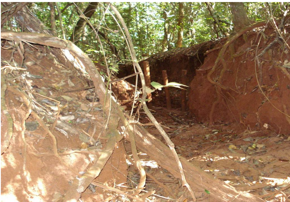
Figura 4: Voçoroca localizada no Interior do Parque do Goiabal. Fonte: Fernanda Pereira Martins, 2010.
