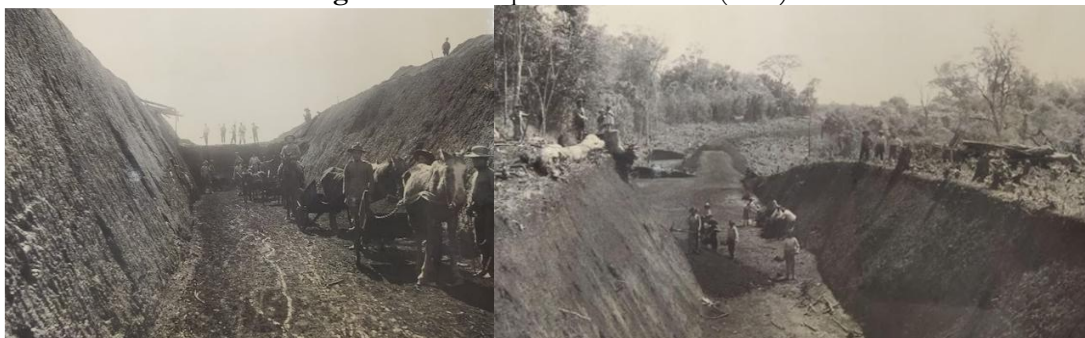
Figura 07. Corte profundo no solo (a e b)
