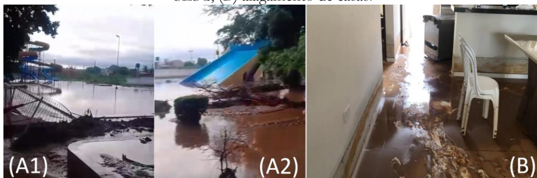
Figura 09: Alagamentos em janeiro de 2024. (A1) e (A2) estragos na estrutura do clube do SESC; (B) alagamento de casas.
